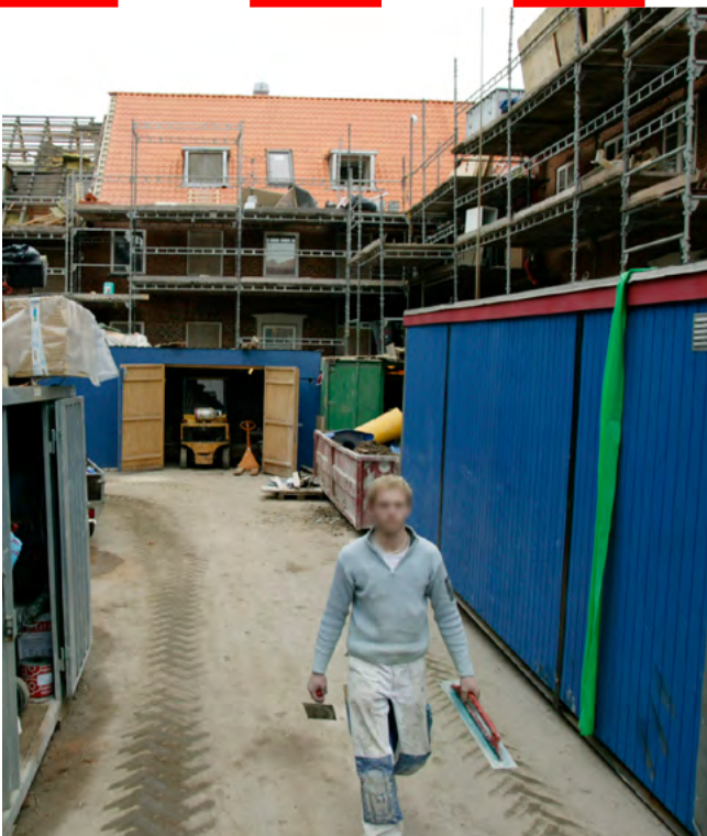
Manglende hjelm på byggeplads
