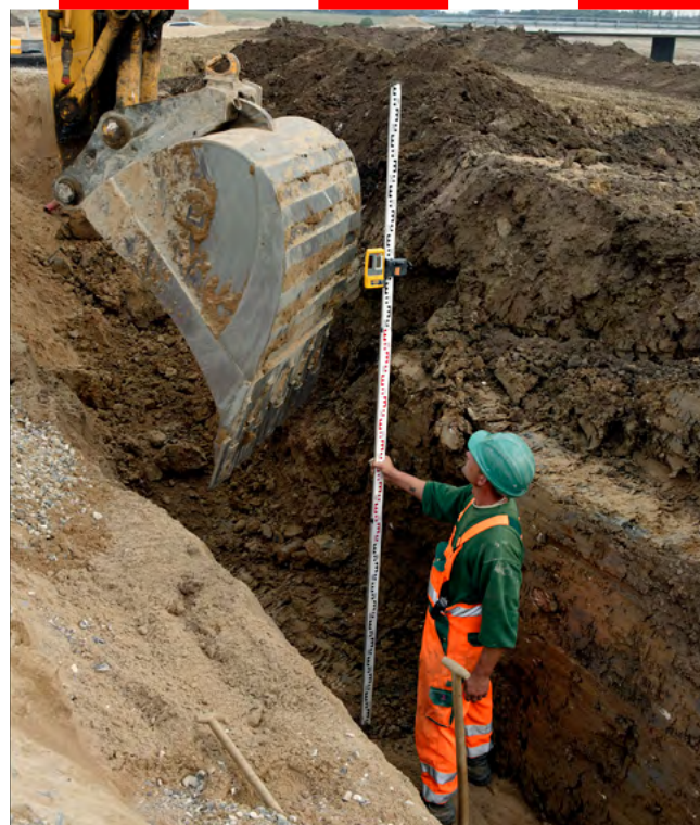
Kvælningsfare ved sammenstyrning af udgravning
