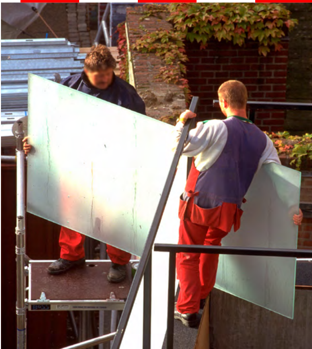
Nedstyrtningsfare og manglende faldsikring
